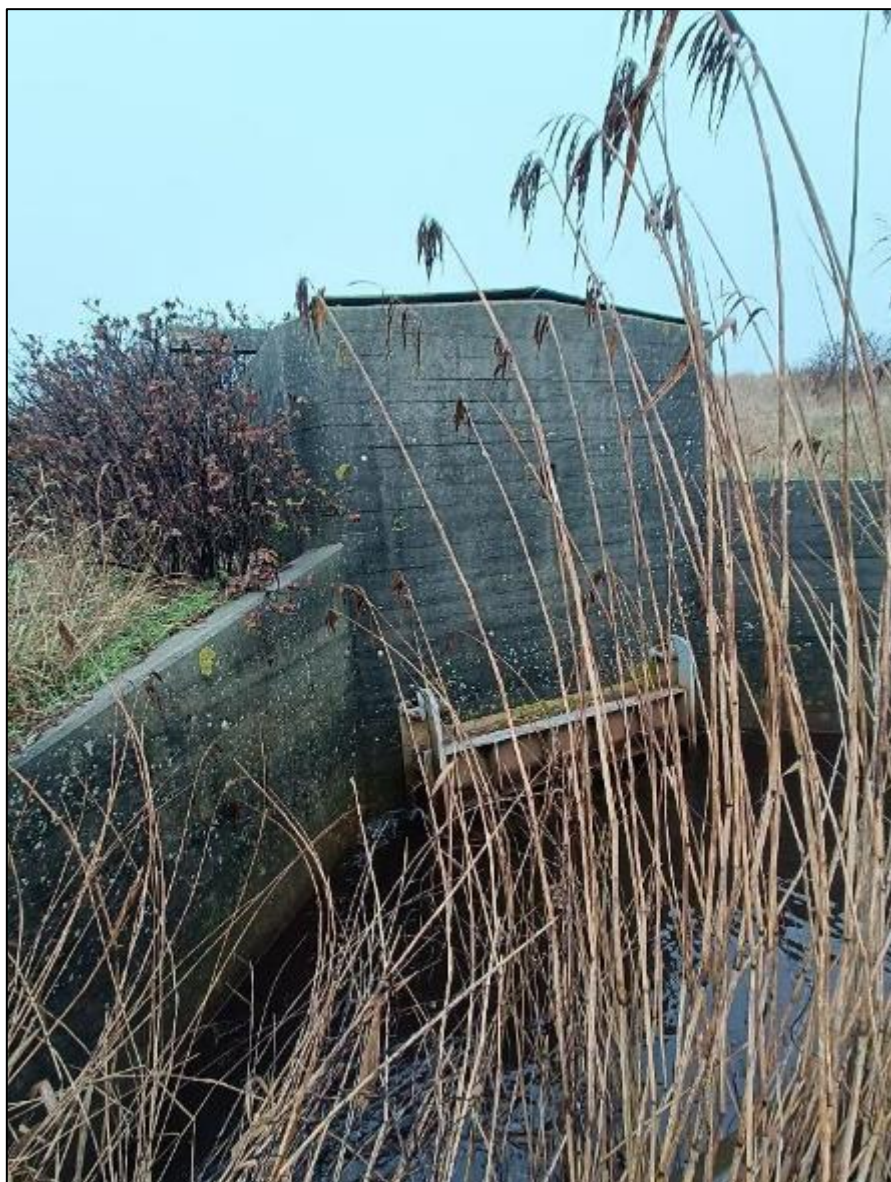
Figur 23: Højvandklap i Novrup Bæk st. 1.996 m ved udløbet under Tjæreborgvej.
